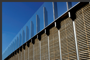
A 113, Berlín ochranné protihlukové zariadenie Johannisthaler Chaussee ■ projektový plán, návrh inžinierskych stavieb, nosných konštrukcií, posúdenie návrhu
